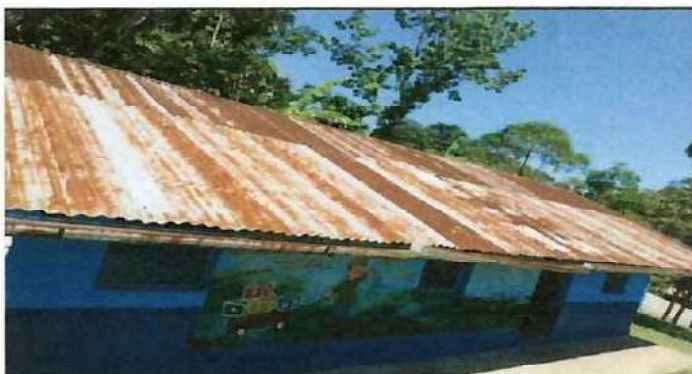
Foto 4: Sustrucion cubierta de lámina del aula IV, esta en muy mal estado ya que en la época de lluvia el agua se infiltra.
