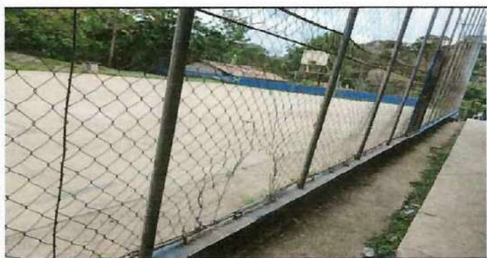
Foto 5: Sustrucion de maya que se encuentra en mal estado.
